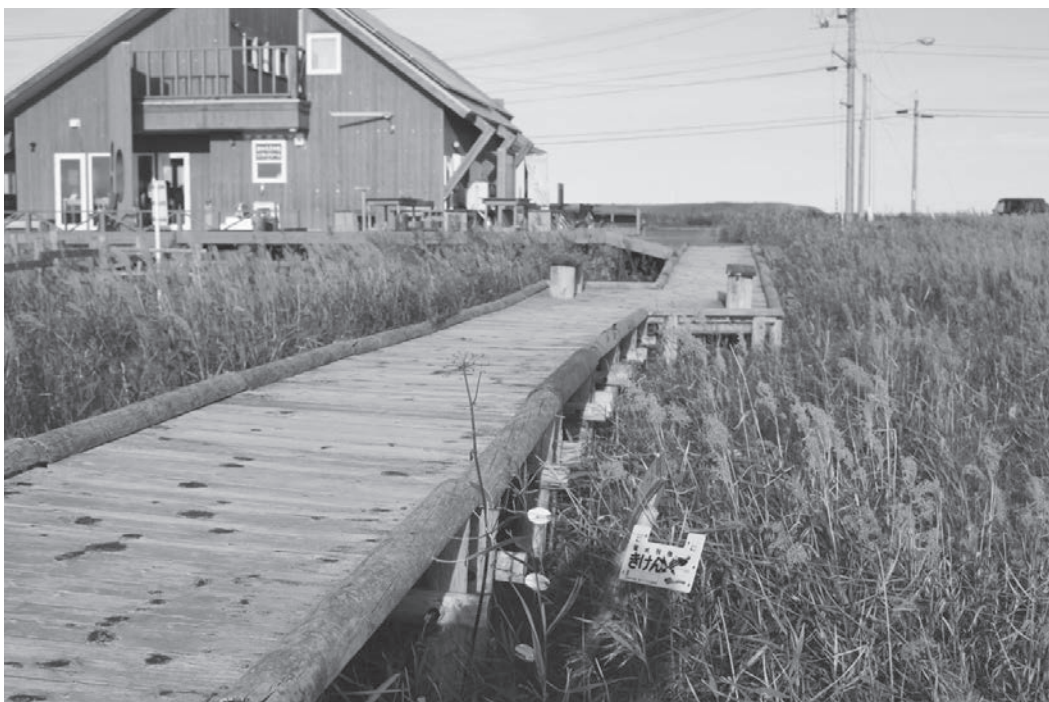
老朽化が進んだ琵琶瀬木道
