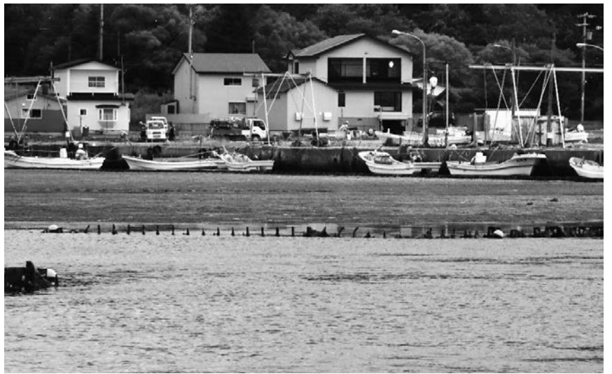
腐食が激しい鋼矢板
