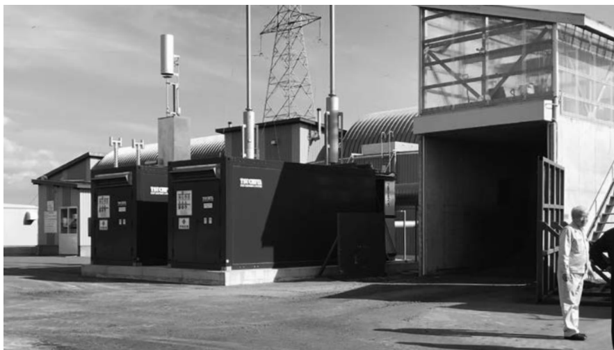
士幌町のバイオガス発電
