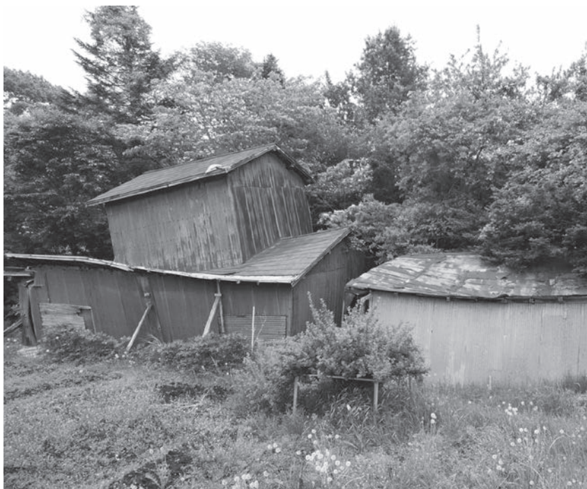
解体が待たれる空き家
