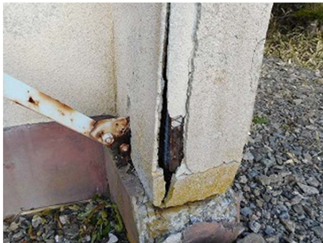
b.湯沸母と子の家 築年数：40年 外壁：C評価 柱型ラスモルタル割れ、内部鉄骨露出錆
