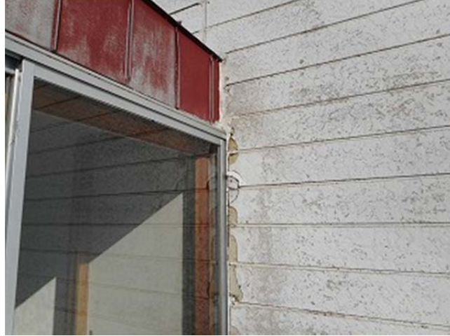
a.熊牛コミュニティセンター 築年数：31年 外壁：C評価 外壁サイディングの劣化
