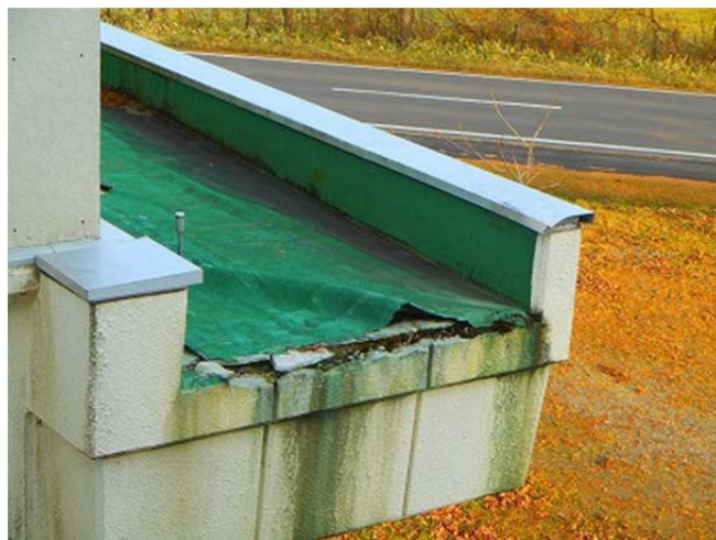
b.茶内第一小学校 体育館 築年数：34年 屋根屋上：C評価 防水剥がれ、CON劣化
