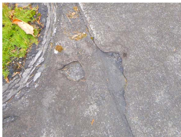
d.茶内中学校 体育館 築年数：33年 屋根屋上：C評価 防水亀裂破れ
