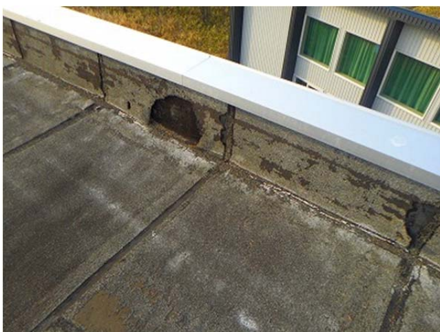
c.茶内中学校 校舎 築年数：34年 屋根屋上：C評価 防水立ち上り劣化、破れ
