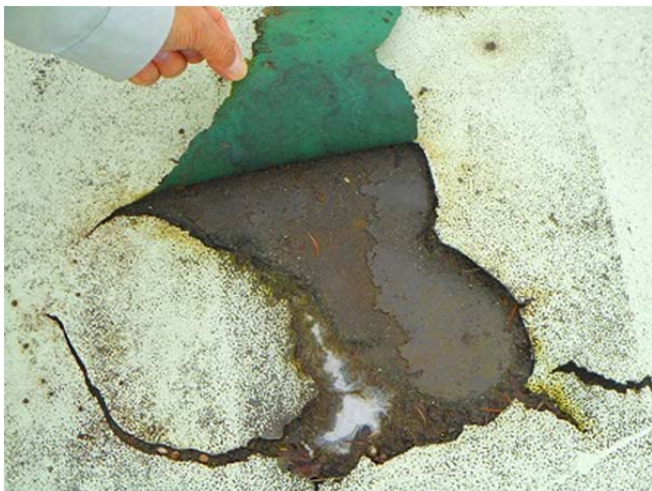
a.茶内小学校 校舎 築年数：28年 屋根屋上：C評価 防水層破損
