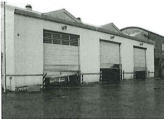
荷捌施設の被害
